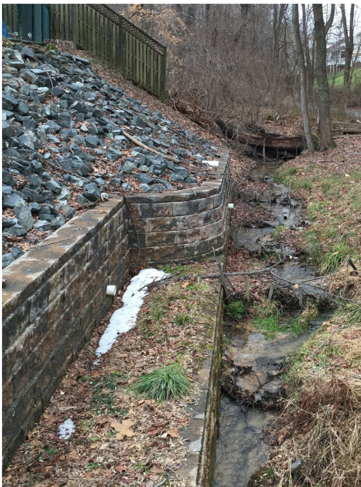
Imagen 38. Este muro de contención de ladrillos evita la erosión de las orillas e impide que la tierra vaya a parar a la masa de agua.
