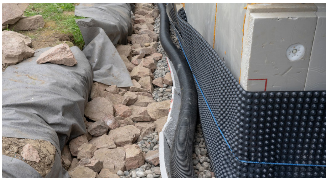
Imagen 3. Instalación de un sistema colector (desagüe de cimientos) e impermeabilización exterior en una vivienda en construcción. Los desagües de cimentación también suelen cubrirse con un calcetín filtrante para evitar que entre suciedad en la tubería y esta cause atascos.
