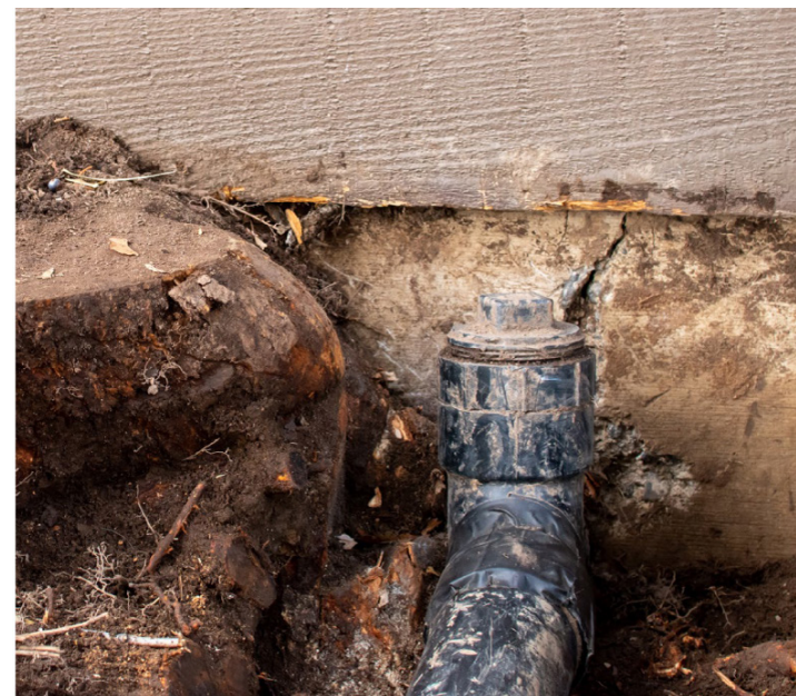
Imagen 9. Un árbol situado junto a la casa dañó la tubería del alcantarillado y agrietó los cimientos de la casa. El agua puede entrar por las grietas en los cimientos de la casa.
