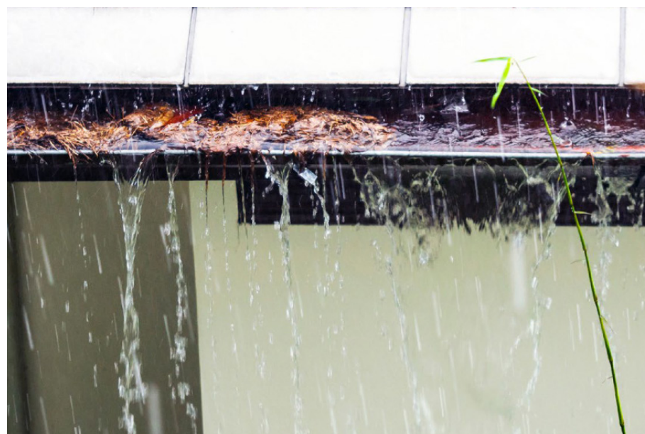
Imagen 4. Esta canaleta de tamaño insuficiente y obstruida por hojas se está desbordando, lo que podría provocar la acumulación de agua contra los cimientos de la casa.
